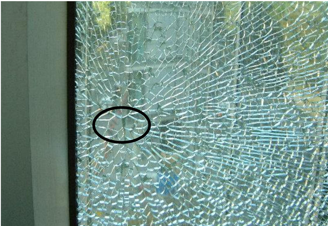
Rupture typique au départ d'une inclusion de NiS
