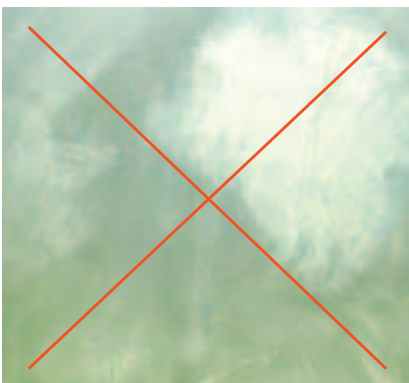
ŹLE: ZANIECZYSZCZENIA NA POWIERZCHNI SZKŁA
