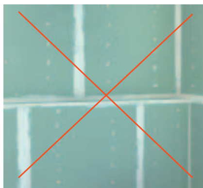
ŠPATNĚ: CHYBÍ STĚNOVÁ PENETRACE
