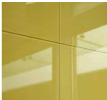
CORRECTO: EVITAR LAS MANCHAS SOBRE LA SUPERFICIE
